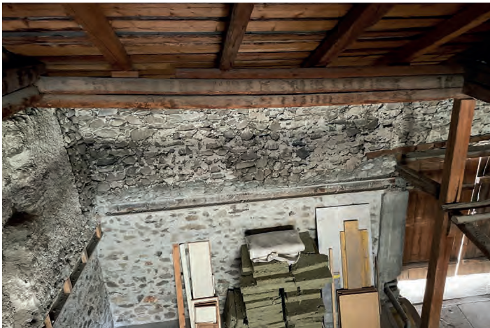
Die Bruchsteinmauer ist ergänzt 19.04.2022
