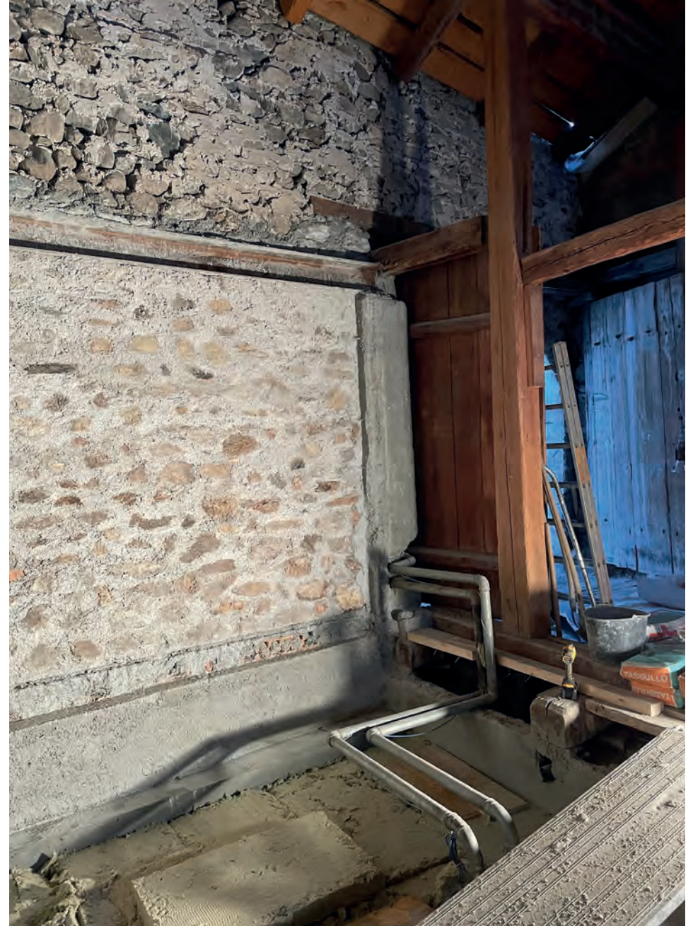
Die Decke über dem Oeltank ist abgebrochen 16.12.2022
